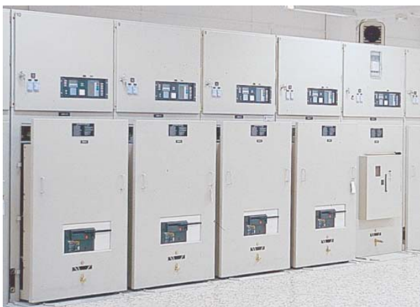
Figura 4: Sistema de protección y control en celdas de distribución
