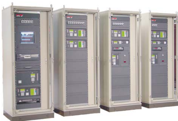
Figura 7: Unidad procesadora central, consola de operación y equipos de posición
